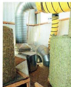
Mit einem T-Stück wird hier Luft aus dem Schlauchkanal oben in die Bodenkanalanlage links abgezwiegt.
